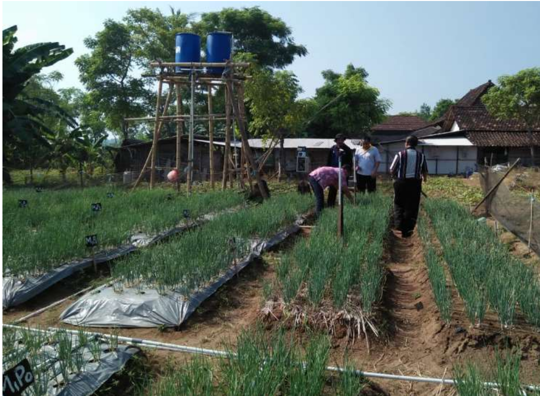
Gambar 10. Instalasi tandon air untuk suplay irigasi lahan (2)
