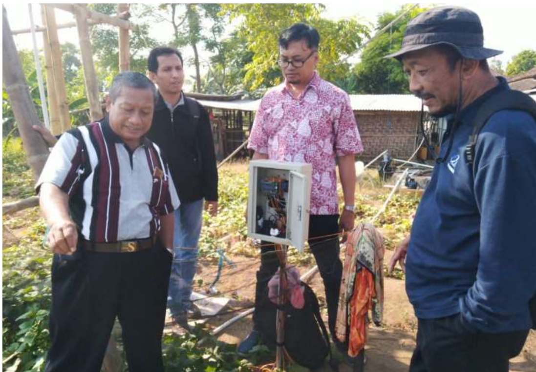
Gambar 11. Box tempat alat otomatisasi pengontrol penyiraman berdasar tingkat kelembaban tanah (1)
